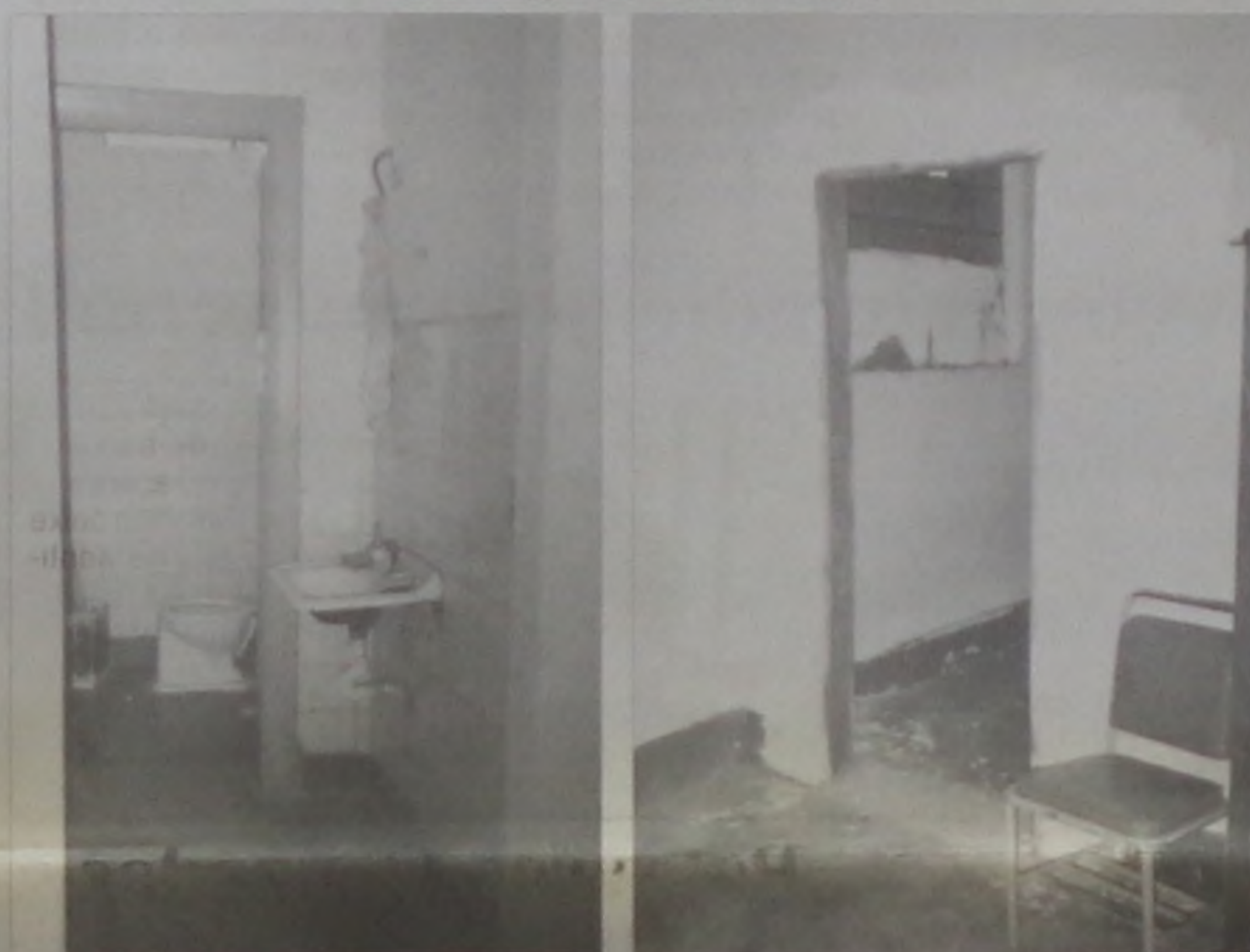
Dependências da Adilp impróprias para realização de exames
