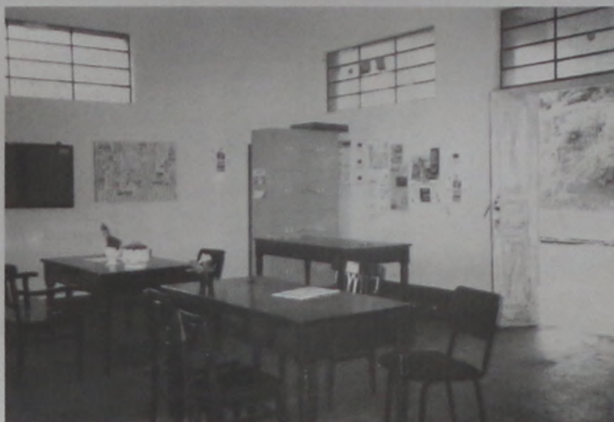
Sala de recepção necessitando de reforma
