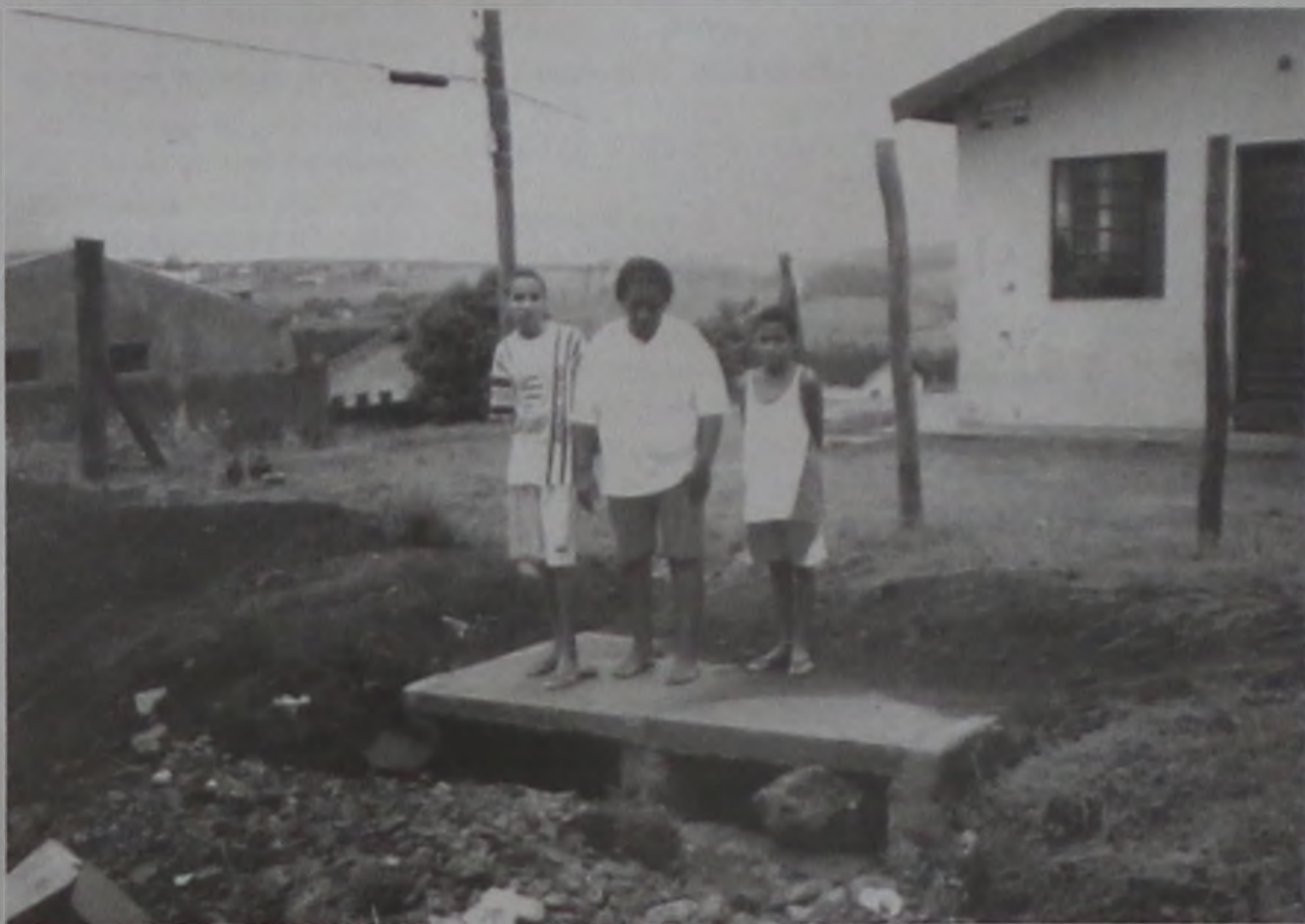
Moradora próxima ao bueiro que entope constantemente
