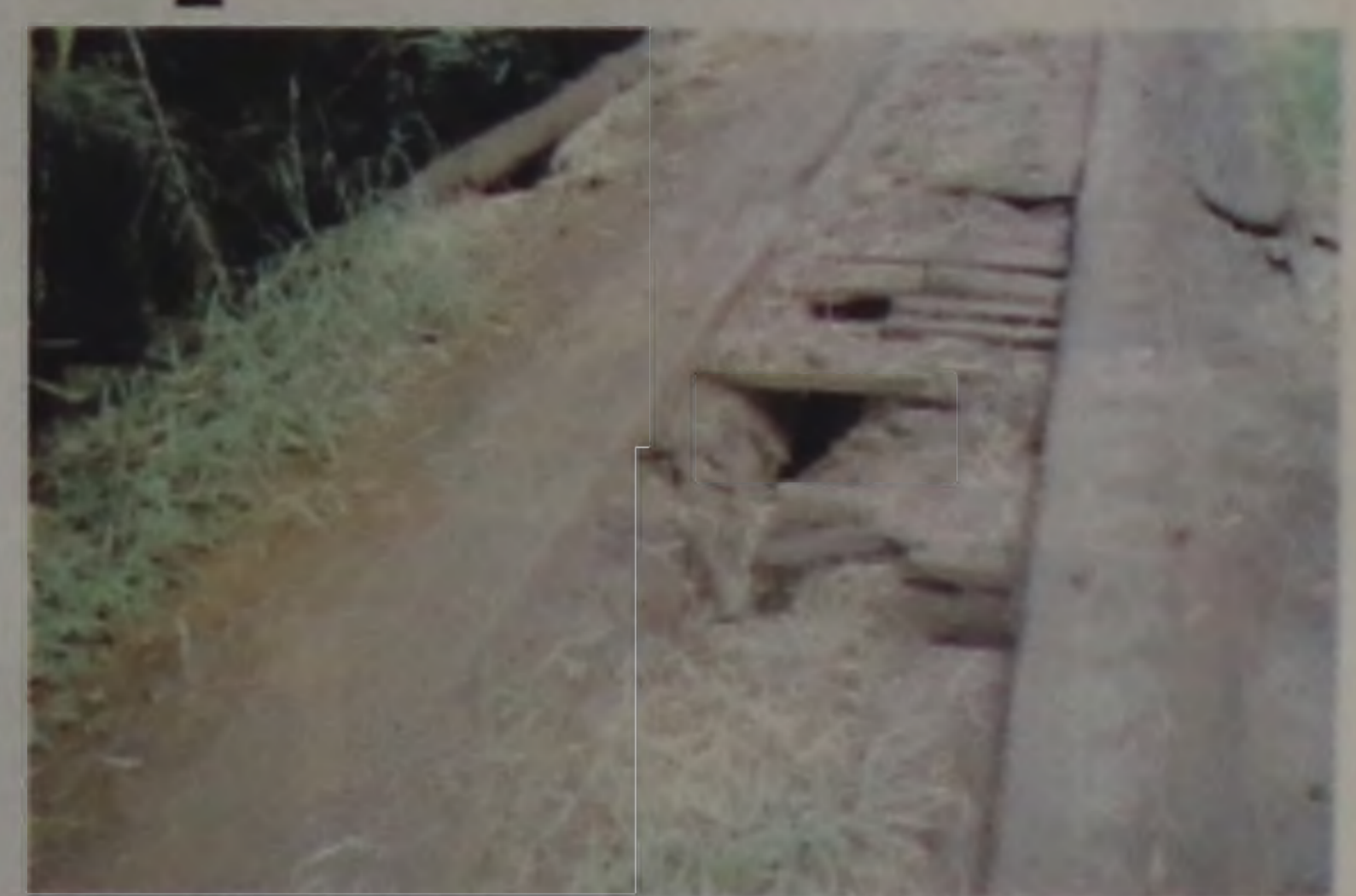
Ponte em péssimas condições oferece risco aos usuários
