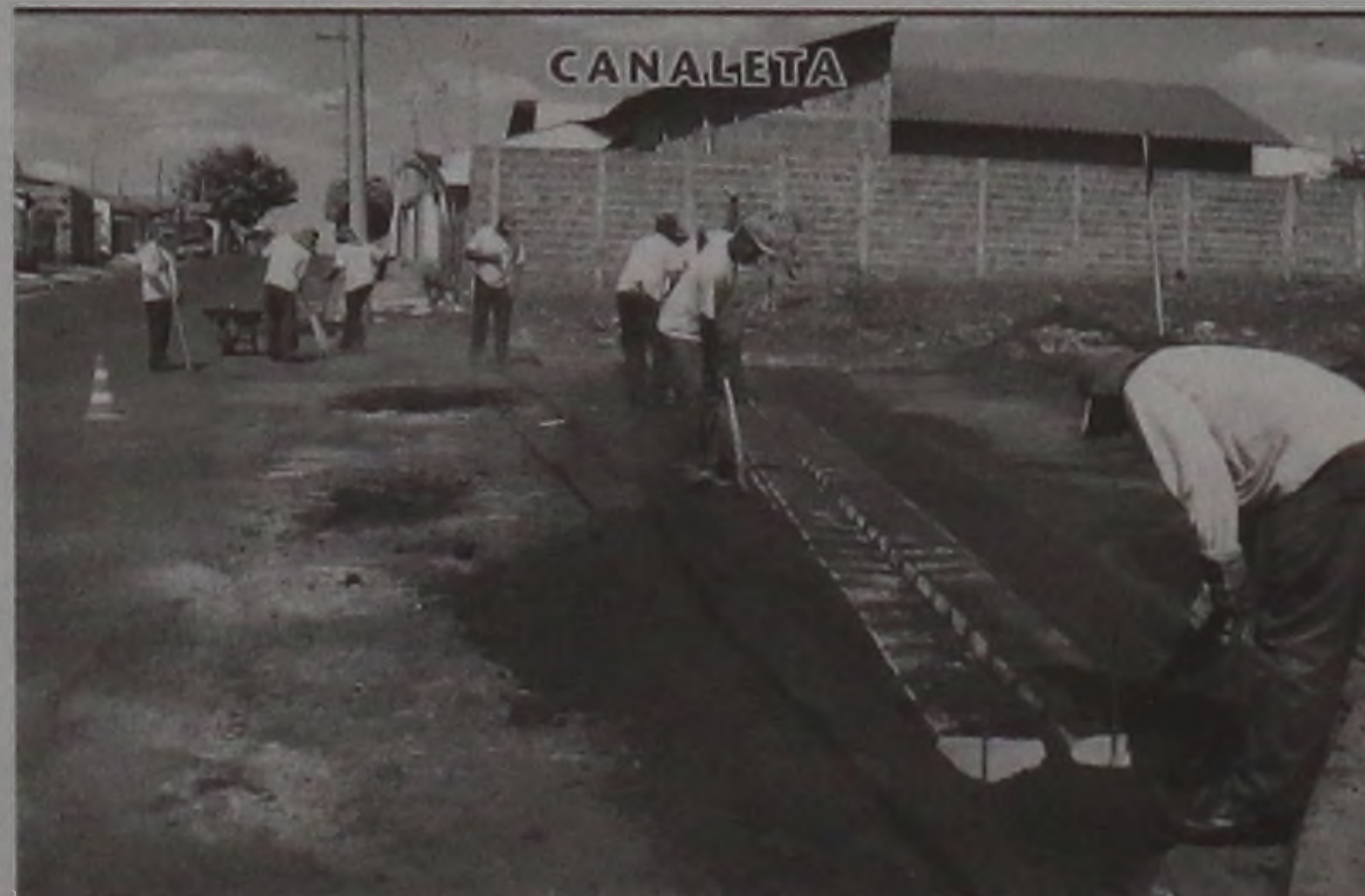
O cruzamento das ruas Sílvio Capelari e Edgar Pinhafiel, no Jardim Príncipe, ganhou um canaletão. Na tarde de ontem, os funcionários da prefeitura trabalhavam no local. O canaletão vai ajudar o escoamento da água.
