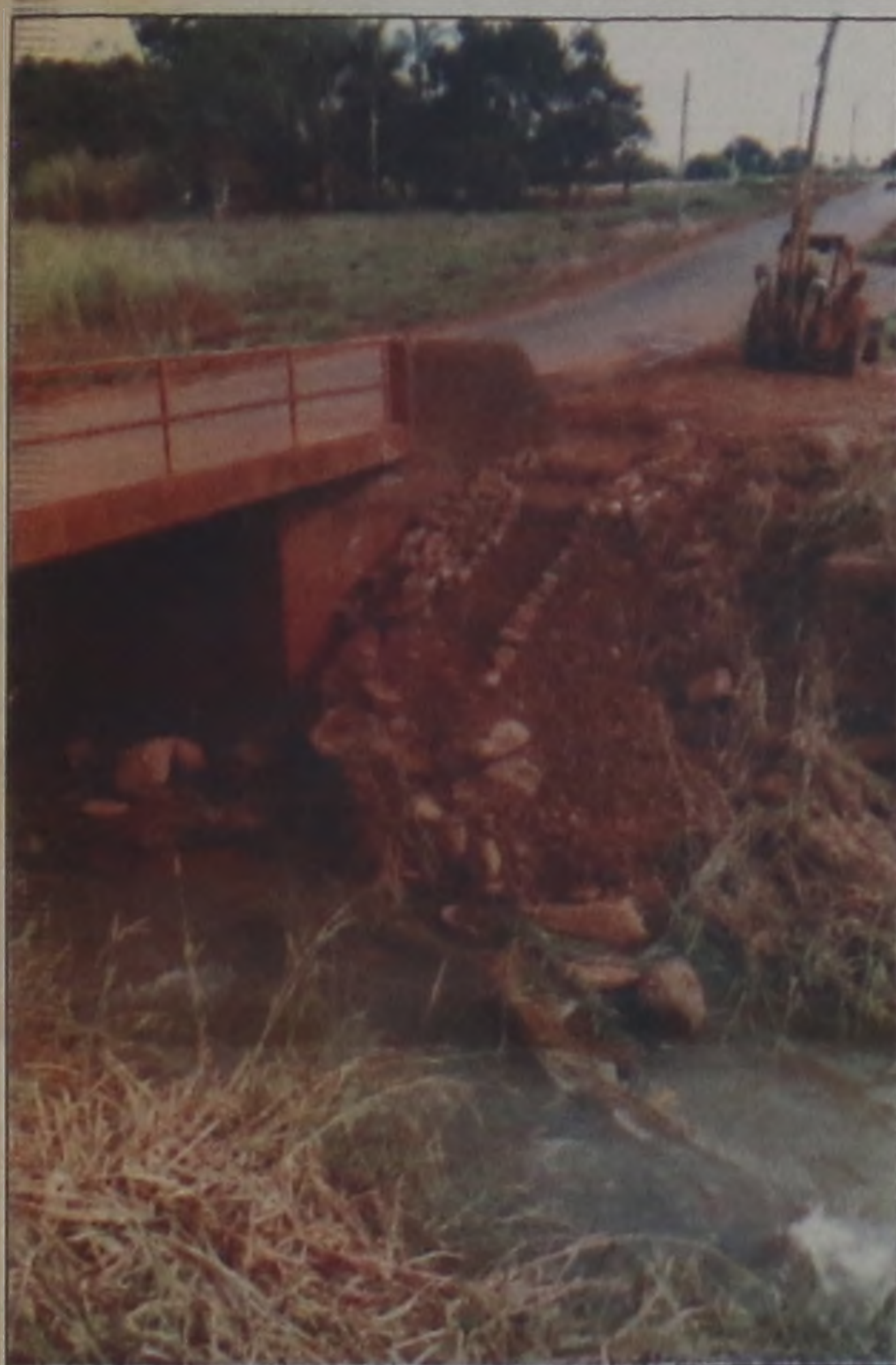
Ponte que dá acesso aos bairros Cachoeirinha e Monte Azul, que deve receber obras de melhoria
