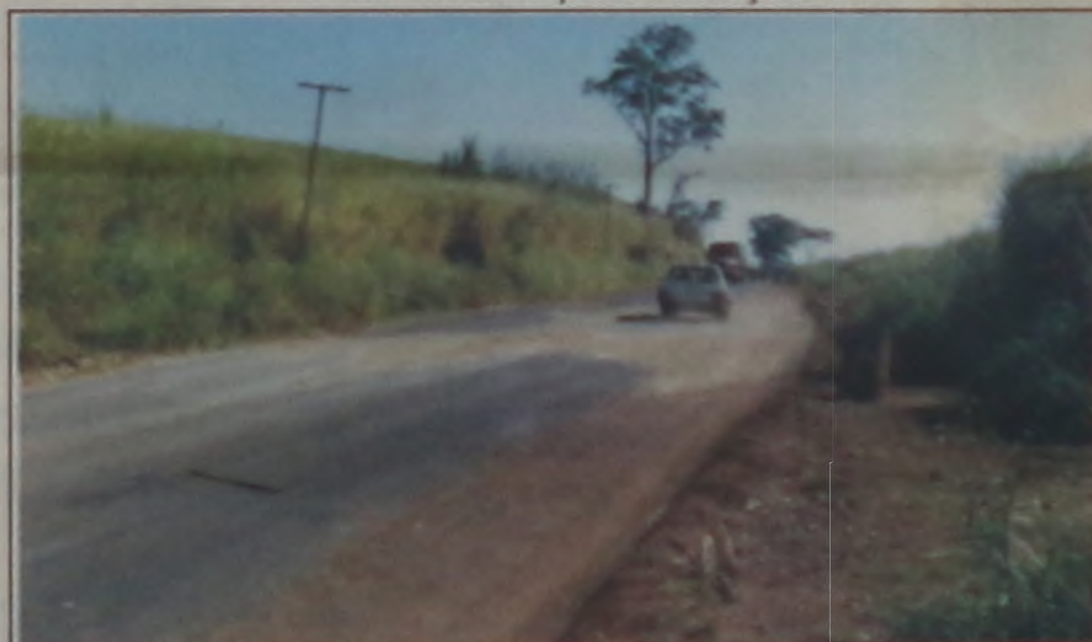
A estrada antes da interdição: condições precárias de segurança
