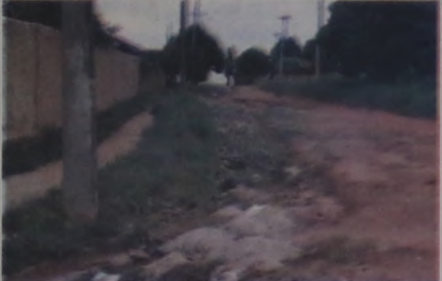
ANTES: A rua Américo Nelli, que sofreu com problemas de erosão...
