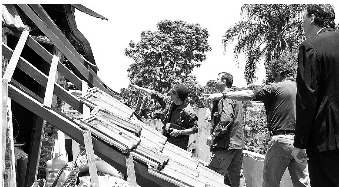
O que sobrou do prédio deve ser colocado no chão hoje, já que a estrutura ficou comprometida
