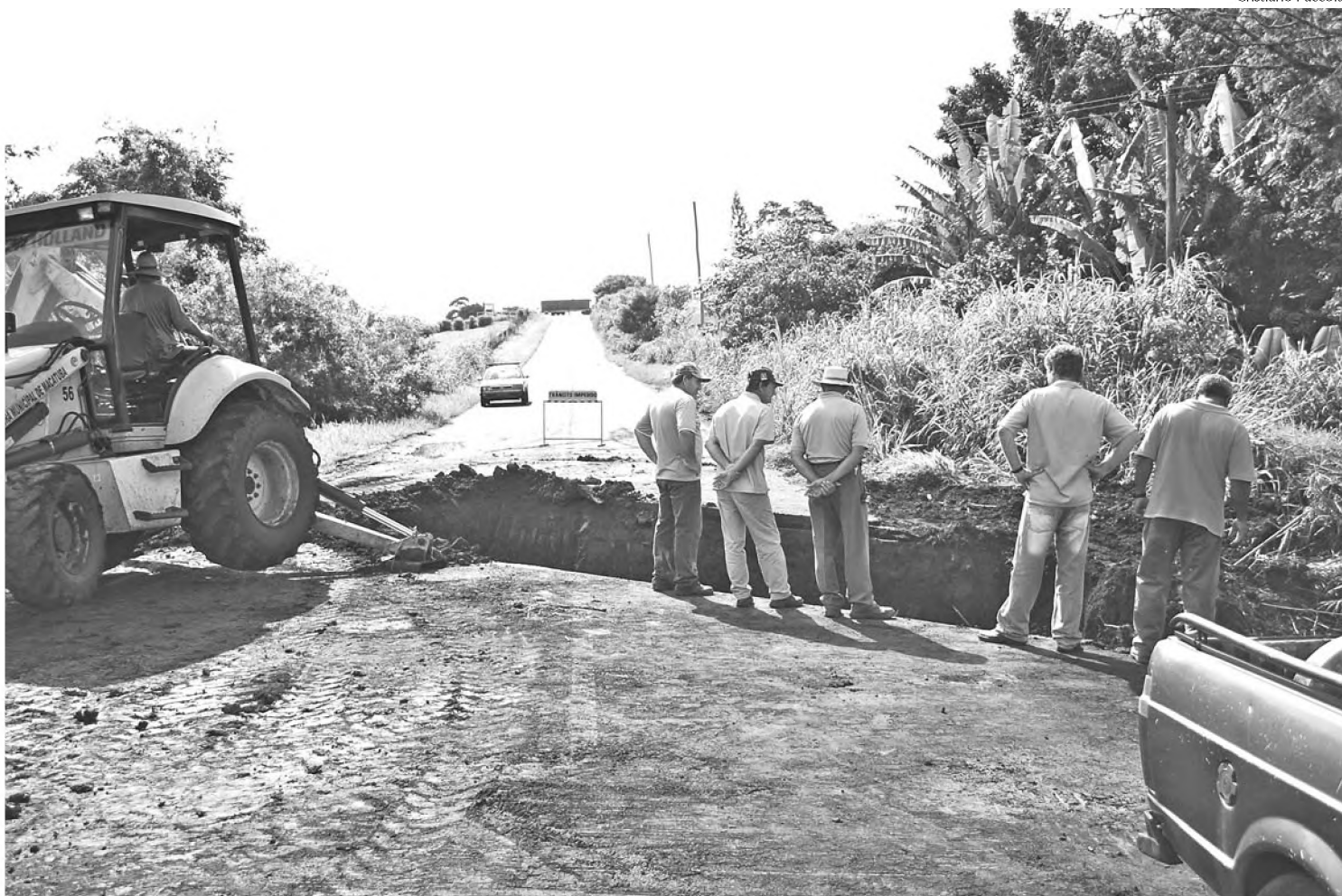
Na estrada vicinal Lauro Perazzoli, a chuva levou parte do asfalto e abriu uma cratera; reparos devem demorar duas semanas
