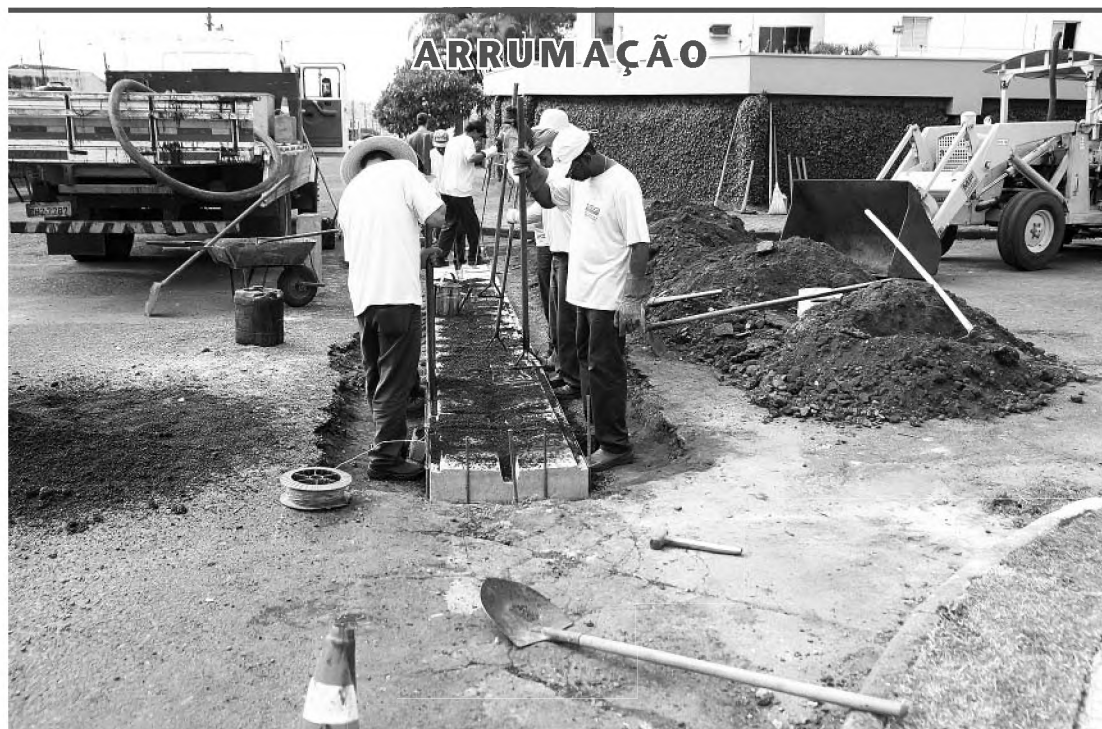
No cruzamento das ruas 28 de Abril com Fernão Dias Paes, no Jardim Ubirama, os funcionários da Prefeitura de Lençóis Paulista estão fazendo uma canalêta para melhorar o escoamento das águas da chuva no local.
