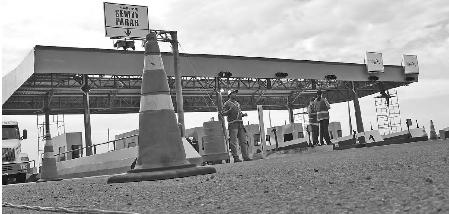
Vista da praça de pedágio em Areiópolis; Estruturas Metálicas Baptistella, responsável pela construção, entregará a obra até terça
