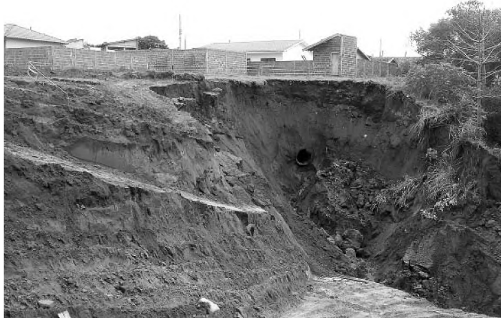
Erosão no Santa Angelina tem 80 metros e MP investiga o caso
