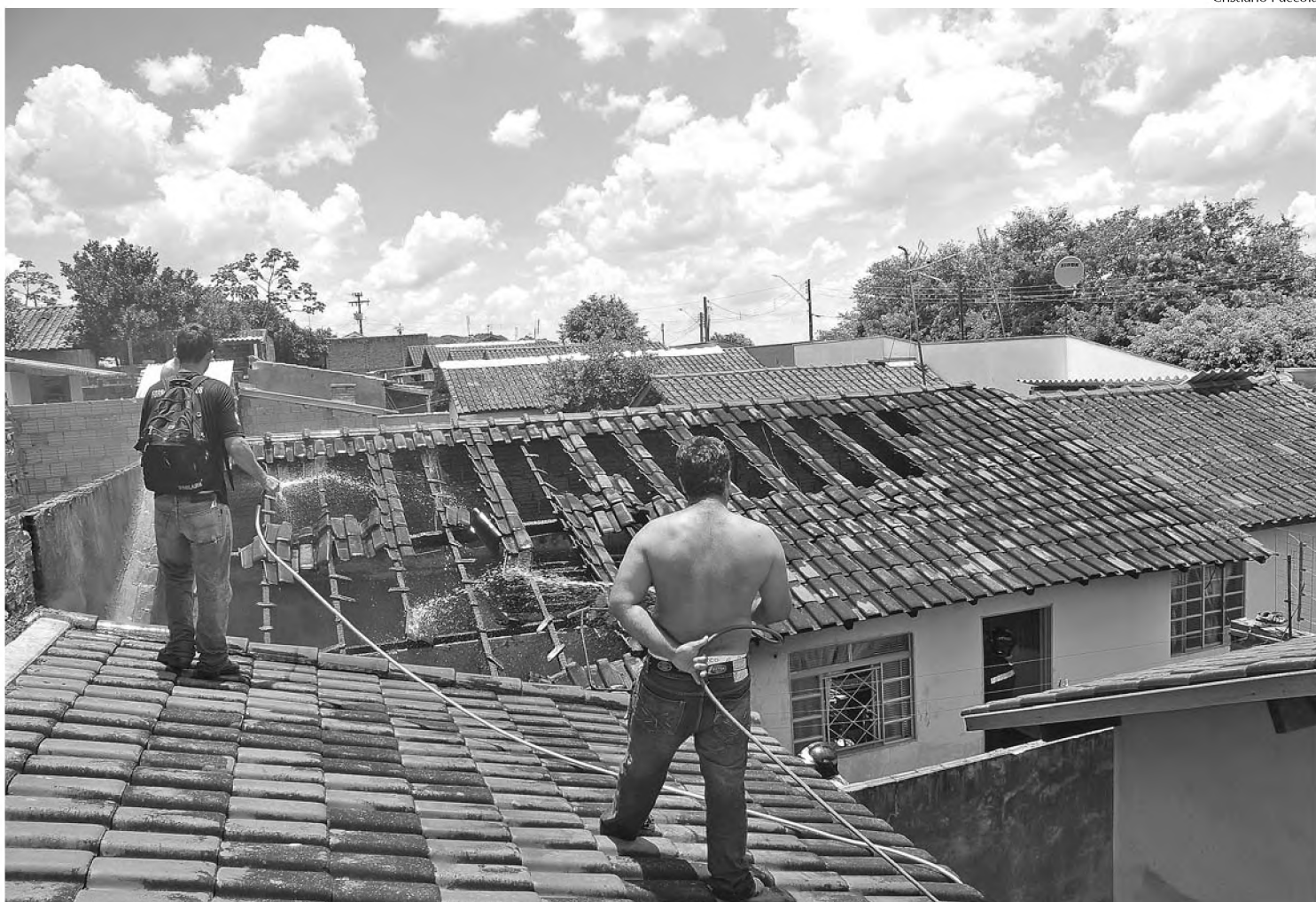
Ontem, fogo destruiu parte de uma casa no Residencial Açai; vizinhos ajudaram o Corpo de Bombeiros a combater as chamas
