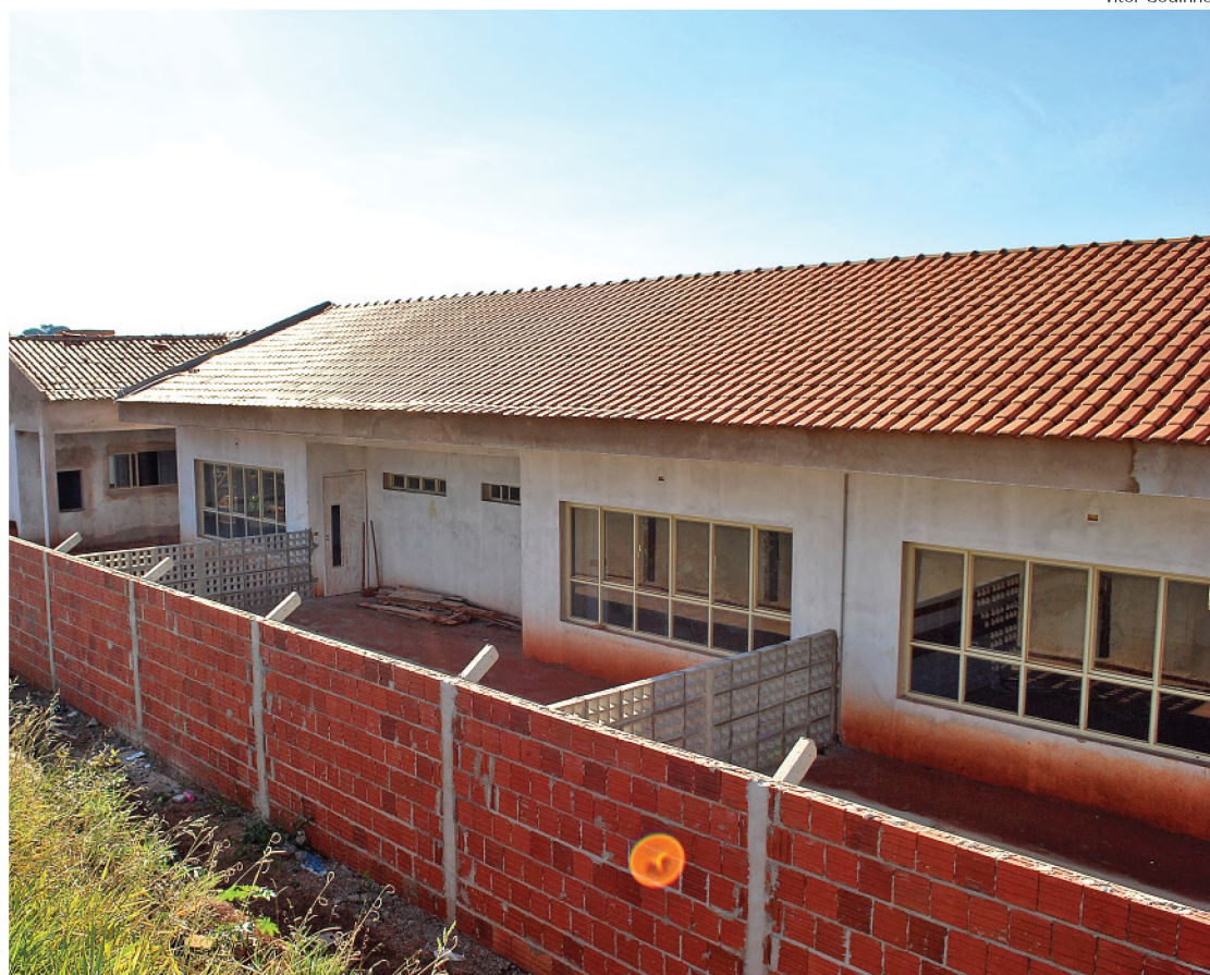
Obra em creche do Jardim Maria Luiza está parada; contrato com empreiteira foi rompido
