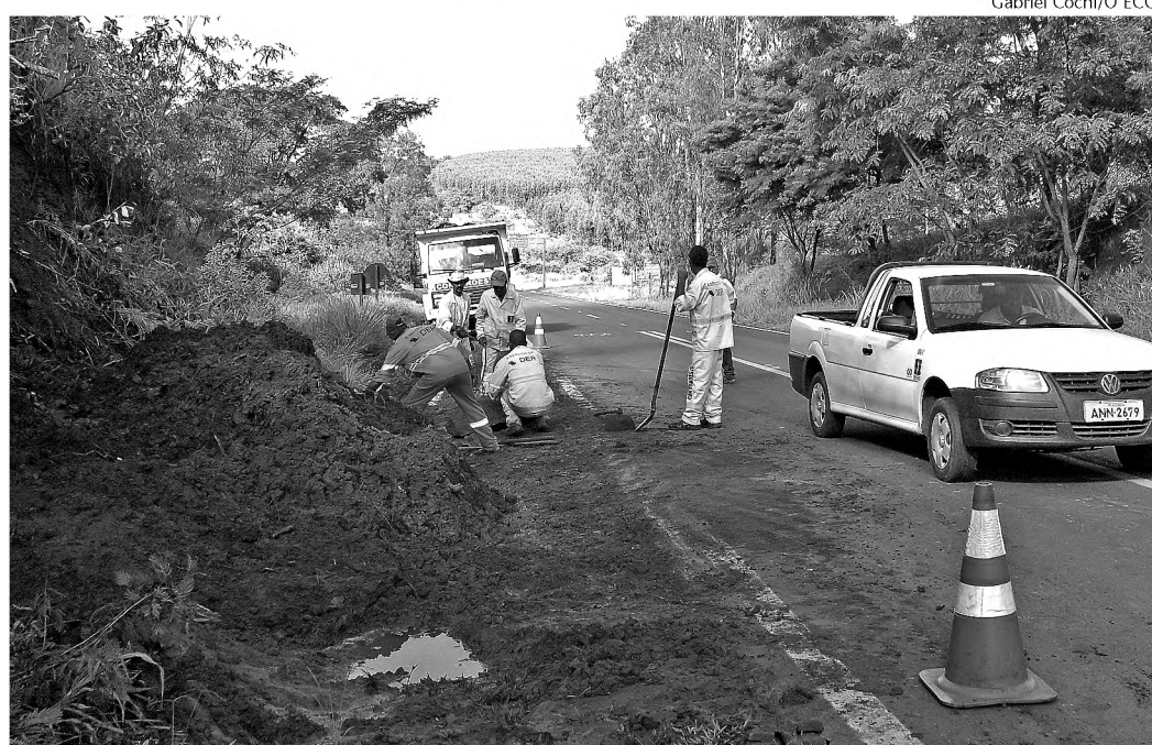
A rodovia Osny Matheus (SP-261) teve uma das pistas parcialmente interditada no começo da manhã de ontem. Um deslizamento de terra ocorreu na altura do bairro Corvo Branco. Muito barro caiu sobre a pista e deu trabalho para as equipes do DER (Departamento de Estradas e Rodagem) que chegaram ao local por volta das 7h. Nenhum acidente foi registrado devido ao deslizamento.
