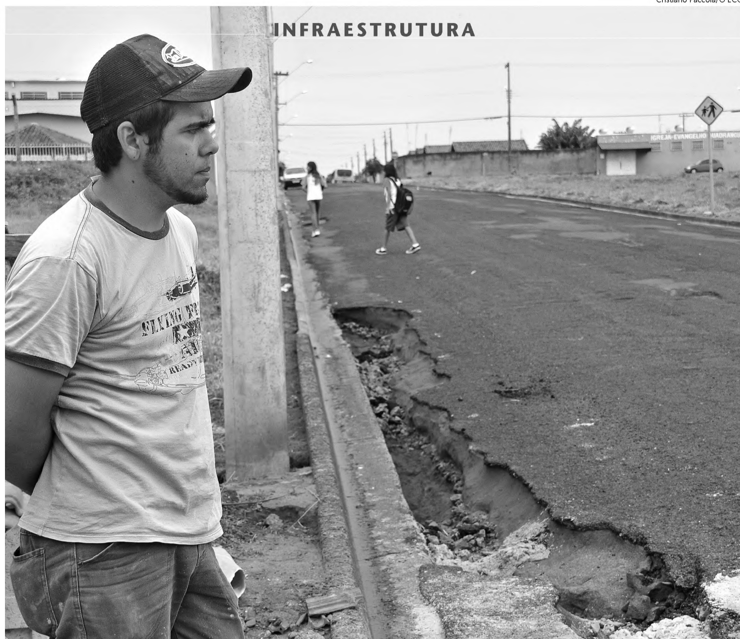
Daniel Marcos Coutinho, morador do Jardim Caju, reclama dos buracos e de erosão que fica em frente de sua casa
