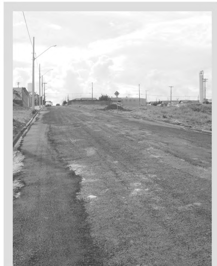
TAPADO Depois da reclamação dos moradores, mostrada pelo O ECO no início da semana, a diretoria de Obras da Prefeitura de Lençóis tapou os buracos de várias ruas do Jardim Caju. Moradores temiam por suas casas e por outras estruturas, como postes de iluminação, devido à profundidade das fendas abertas no asfalto pela chuva.
