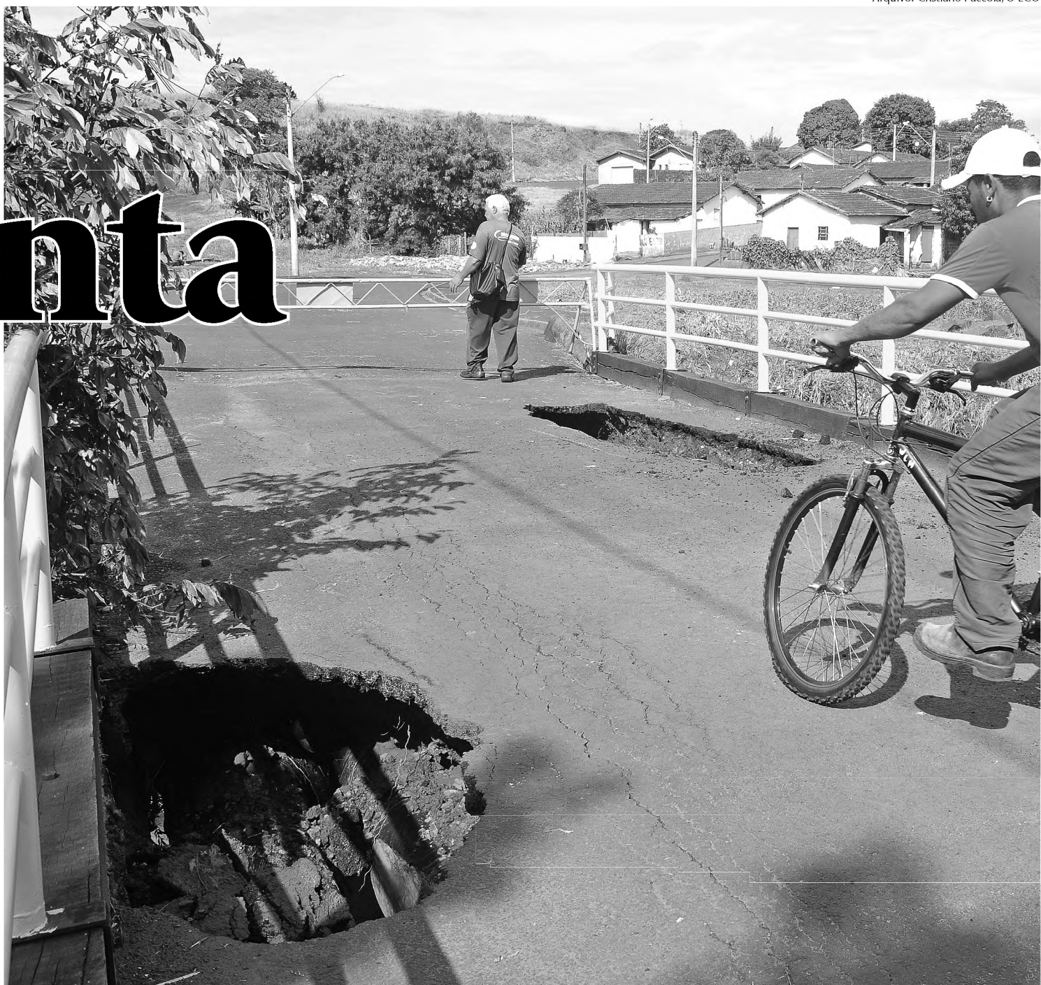
Recursos serão usados para reconstrução de pontes e construção de muros de contenção em vários bairros da cidade
