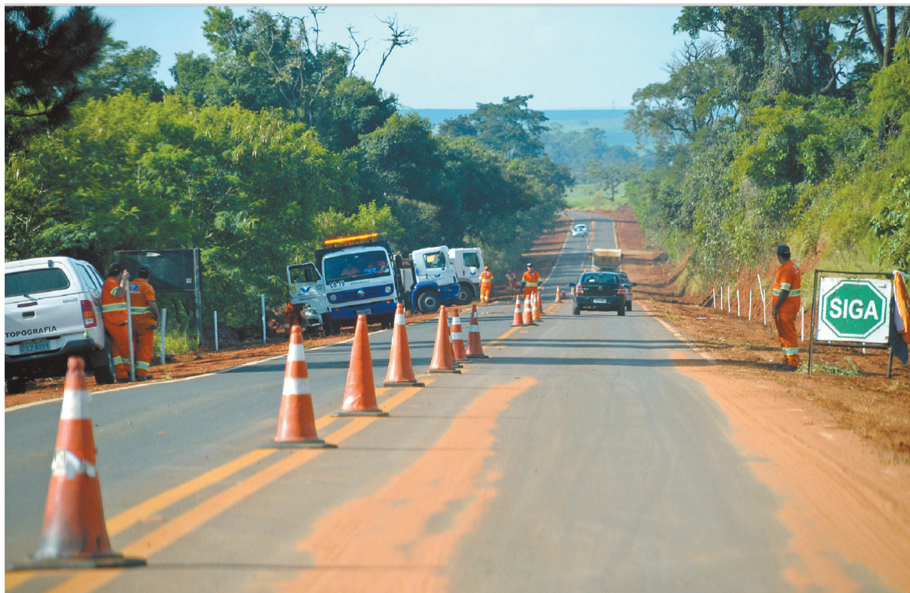
EM OBRAS - Trecho da Rodovia Osny Matheus que está sendo reformado pela Vale do Rio Novo
