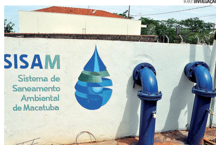
SISAM - Em Macatuba, a água vem de três poços profundos; reservatórios têm capacidade para acumular 2 milhões de litros de água
