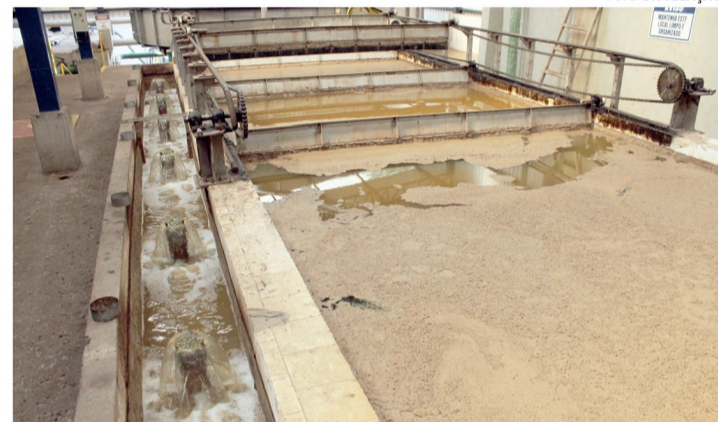
REUSO - Tanques de tratamento que integram o circuito fechado
