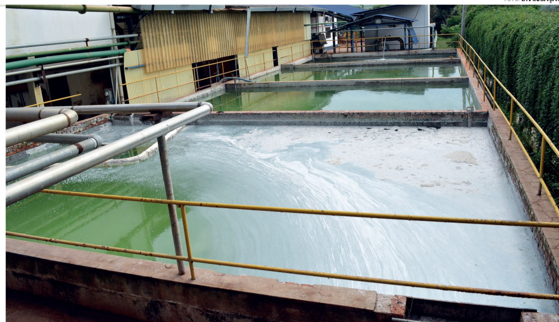
TANQUES - Reuso de água é possível por conta da implantação de um circuito fechado que trata a água usada
