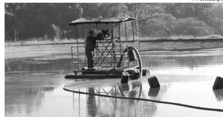
NO LIMITE - Lagoa anaeróbica estava assoreada e tratando cerca de 80% dos dejetos
