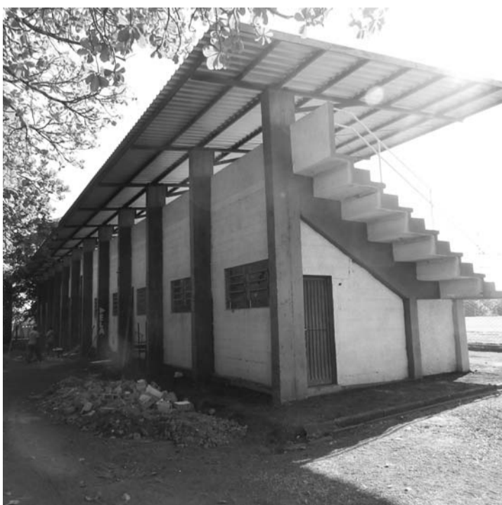
OBRA - Projeto contempla a reconstrução dos sanitários, reforma dos vestiários e arquibancada
