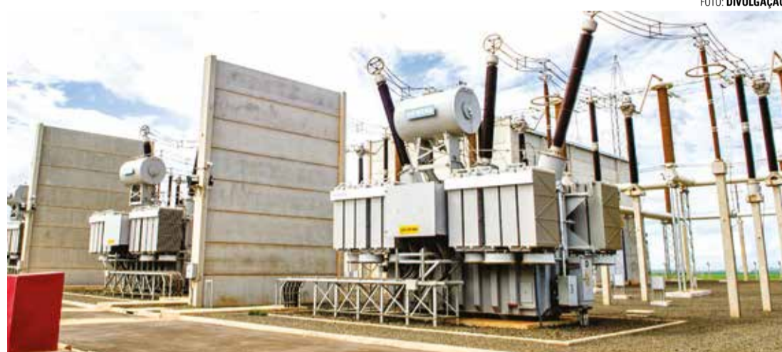
GIGANTE - Termelétrica da Bracell é, atualmente, a maior usina movida a biomassa em todo o Brasil
