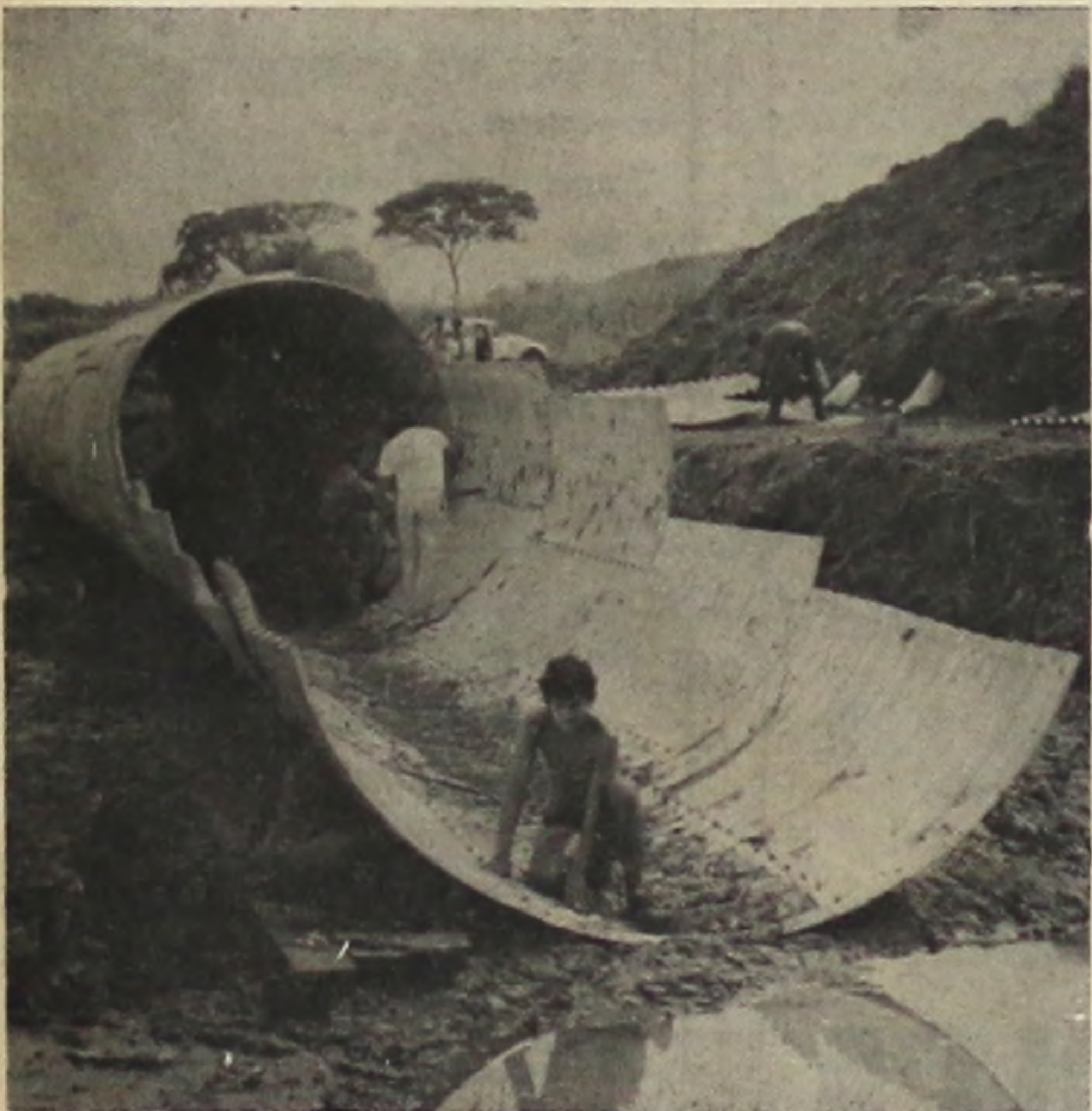
Tubulações para o escoamento da água sob o aterro.
