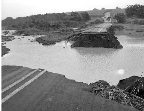
Rodovia da Amizade teve a ponte destruída
