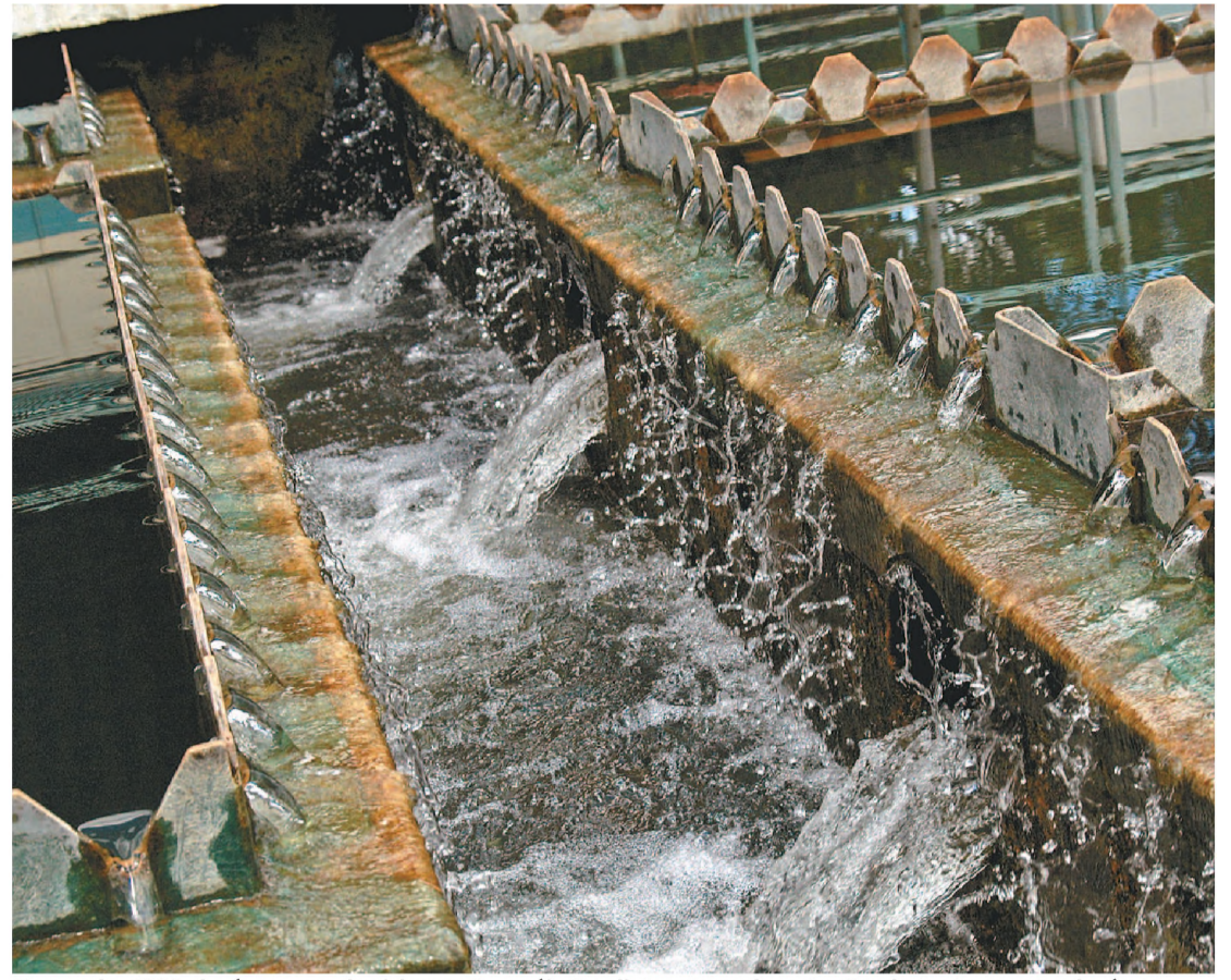
Cerca de 60% da água produzida em Lençóis Paulista saem da estação de tratamento de água
