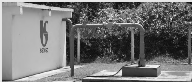
Poço e reservatório da Sabesp em Areiópolis
