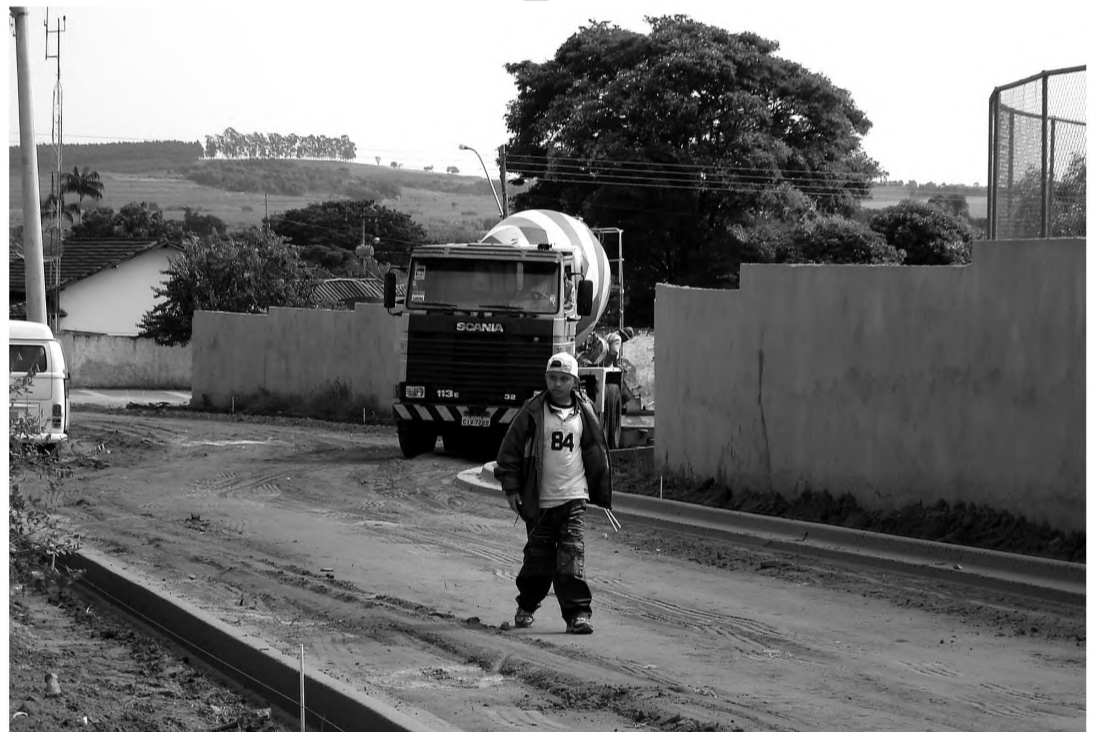
Rua do conjunto habitacional Anitta Leão recebe guias e preparação para ser asfaltada
