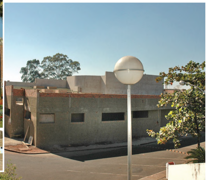
Na parte de trás do salão estão sendo construídos os novos sanitários e o camarim
