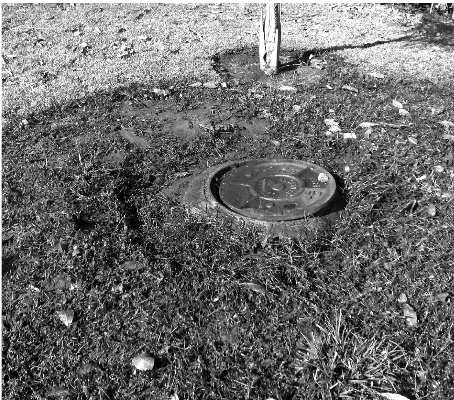
Mancha de óleo no gramado ao redor de tampão da rede de esgoto rompido na praça Ézio Frezza, próximo ao rio Lençóis
