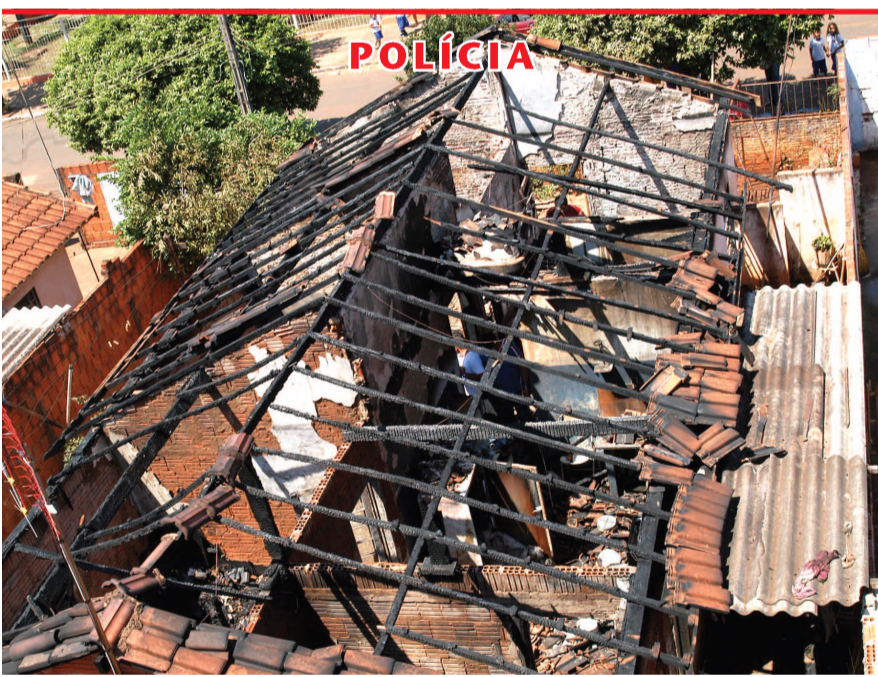
Fogo consumiu até o telhado da casa; aposentado morreu carbonizado
