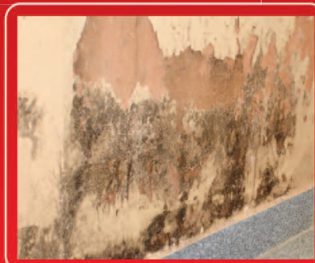
Não coloque a saúde de sua família em risco, evite fungos e bolores nas paredes causados pela infiltração.
