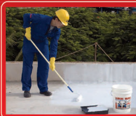
Infiltração em laje exposta, Lajecril é a resposta!
