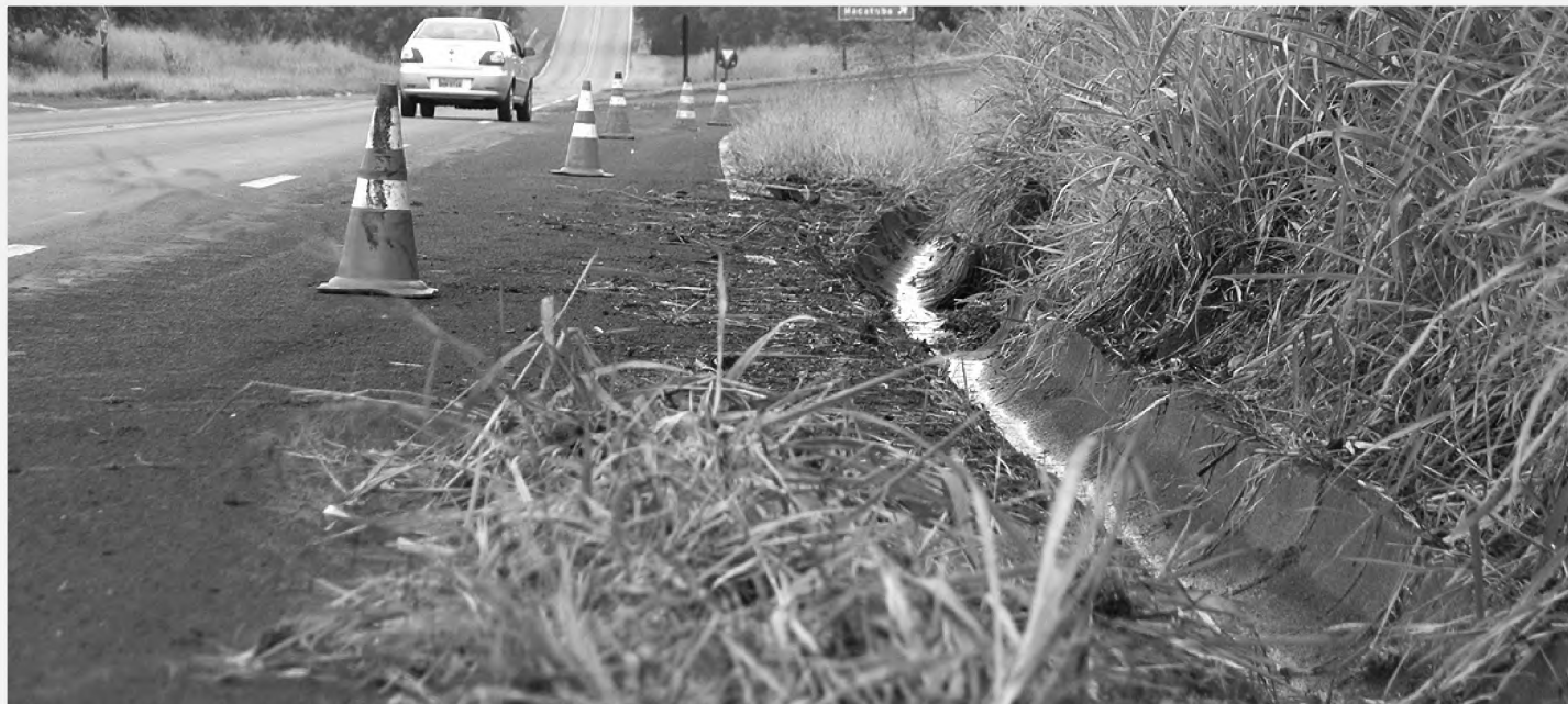
Na manhã de ontem, funcionários do DER faziam a limpeza de trechos do acostamento da rodovia Osny Matheus (SP-261), na altura do trevo Macatuba pelo bairro Aguiinha. Tanto o acostamento como a pista estão em péssimo estado de conservação.
