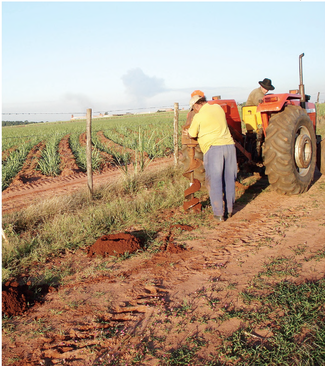
Funcionários da prefeitura trabalham na colocação de cerca na área onde será montado o novo lixão
