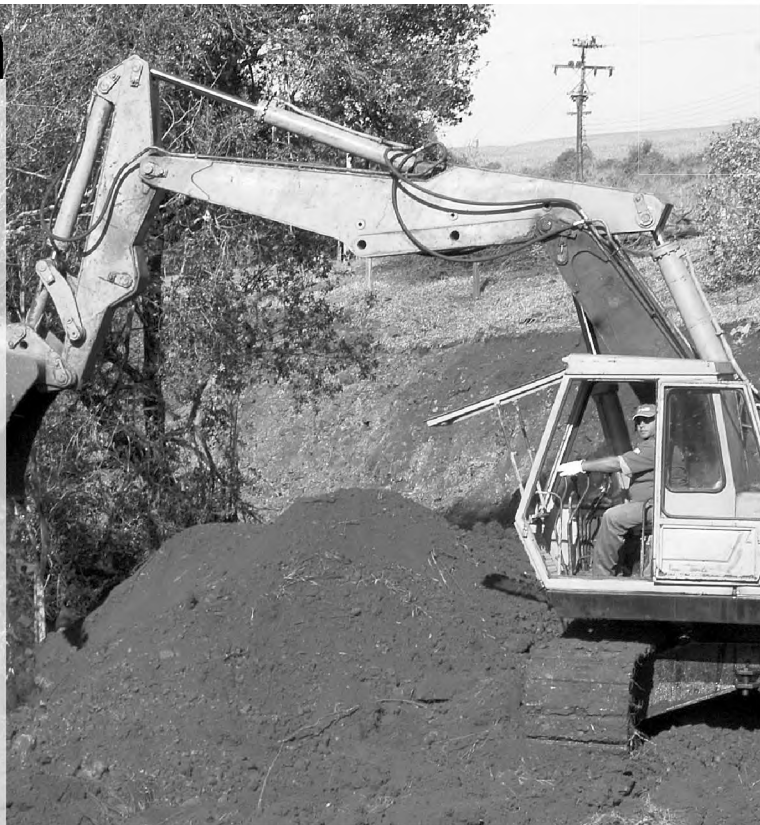
Na tarde de ontem, funcionários do SAAE trabalhavam na construção do emissário de esgoto em área da Fazenda Lageado
