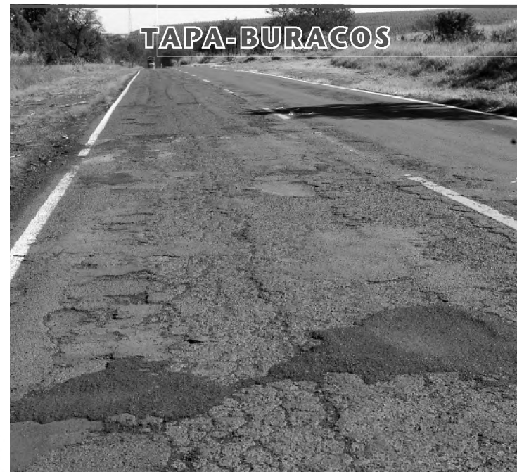
O DER (Departamento de Estradas de Rodagem) começou na quinta-feira 26 uma operação tapa-buracos na rodovia Osny Mathus (SP 261). As chuvas que voltaram a cair com frequência abriram verdadeiras crateras na estrada e em alguns pontos localizados entre Lençóis Paulista ofereciam grande risco para os motoristas.
