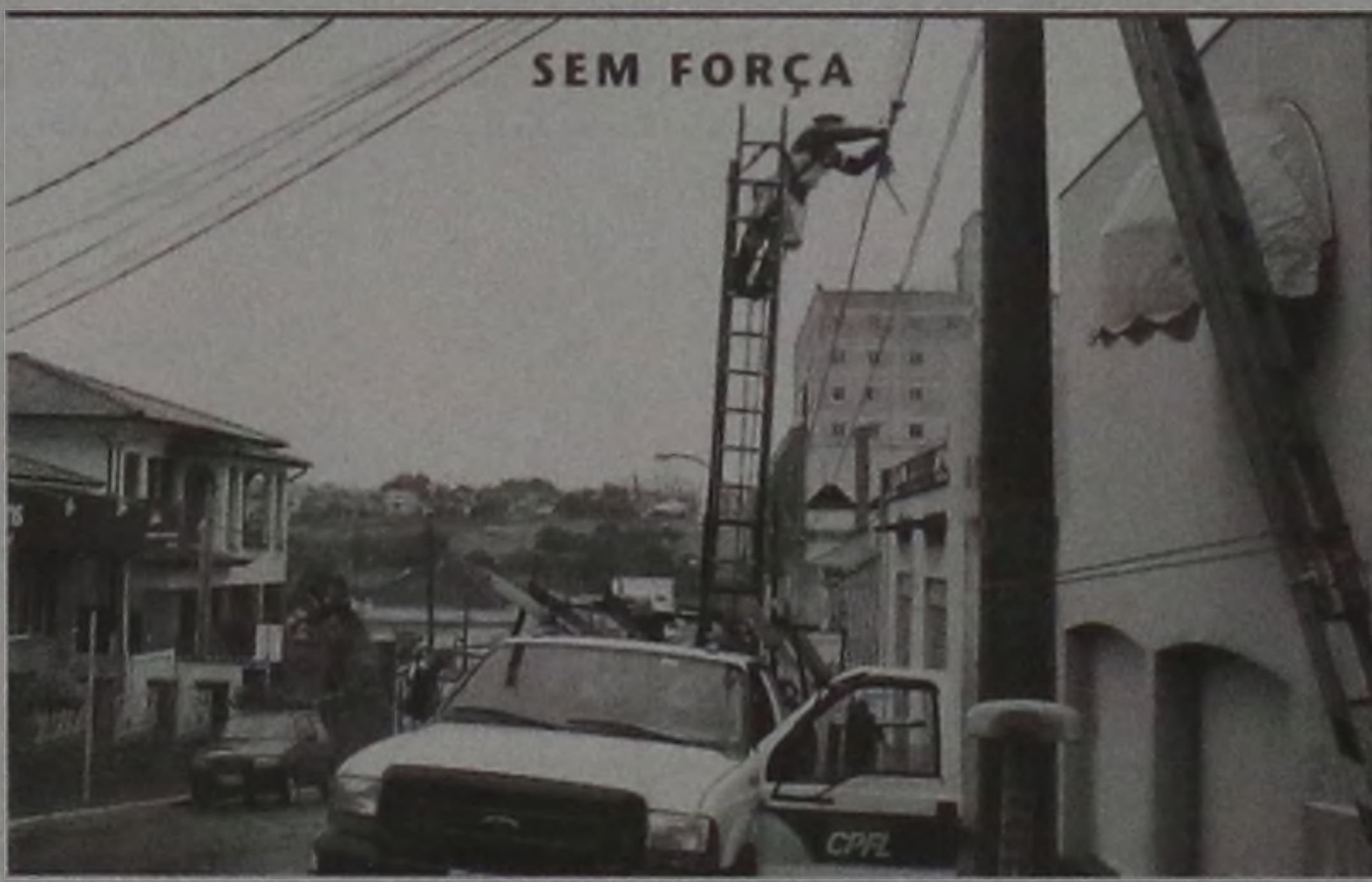
Na manhã de ontem, funcionários da CPFL (Companhia Paulista de Força e Luz) trabalhavam embaixo de chuva para arrumar um fio de energia que caiu na rua Pedro Natálio Lorenzetti, depois de enroscar em um caminhão, tipo baú. Por causa do incidente, boa parte da região central ficou sem energia por 40 minutos.
