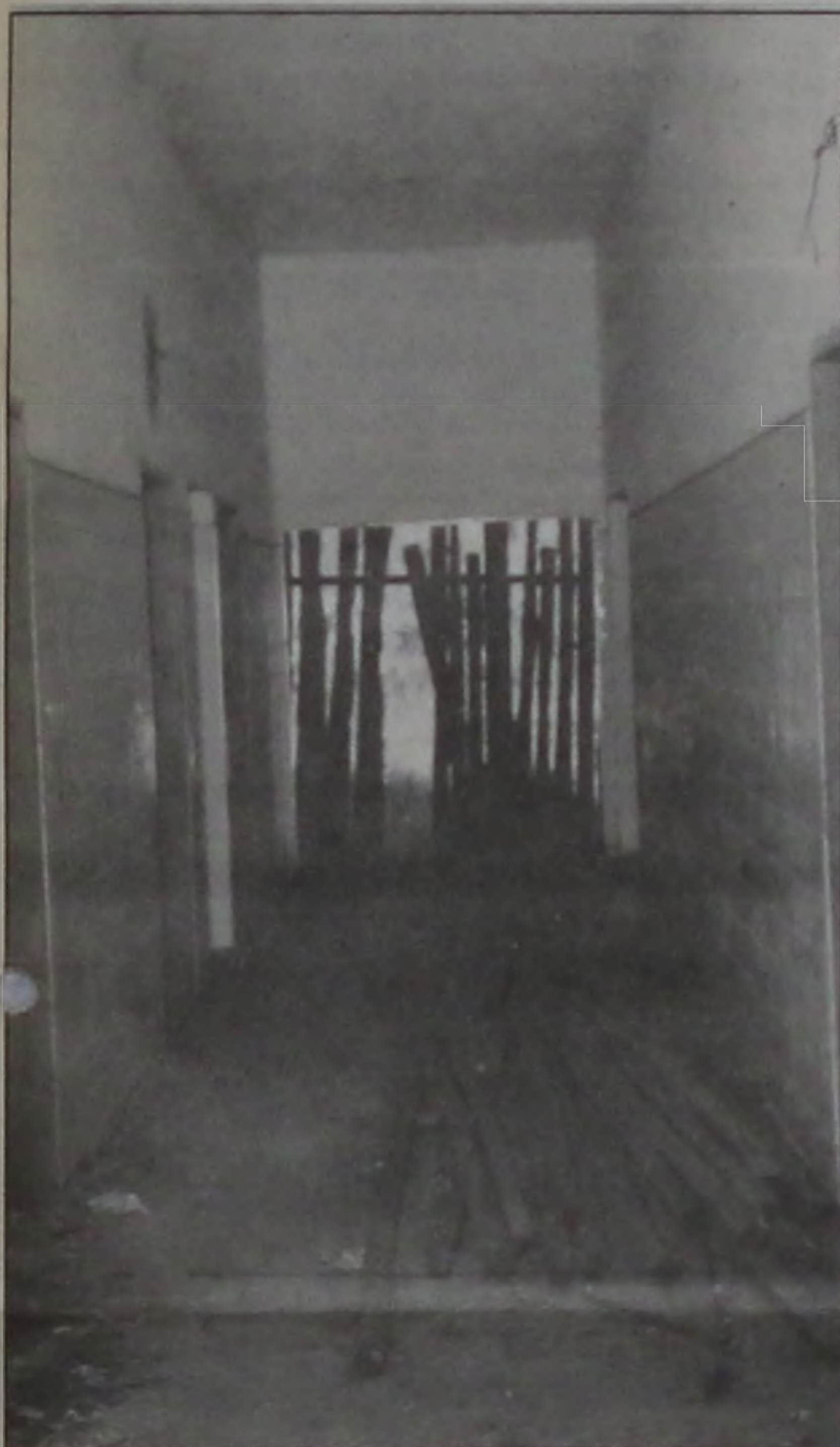
2º bloco do Hospital Municipal de Areiópolis: obras paradas desde 93
