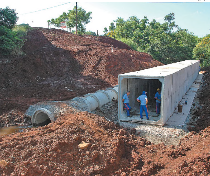
Obras na Arthur Balsa, onde asfalto cedeu por causa das chuvas
