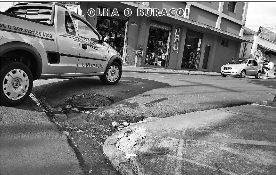
Um buraco localizado bem no cruzamento das ruas Nove de Julho e Geraldo Pereira de Barros tira os motoristas do sério. Naquele trecho da Geraldo é comum veículos estacionados e muito movimento. Quem vem da Nove de Julho tem que fazer malabarismo para desviar do buraco e, muitas vezes, também de outros carros.
