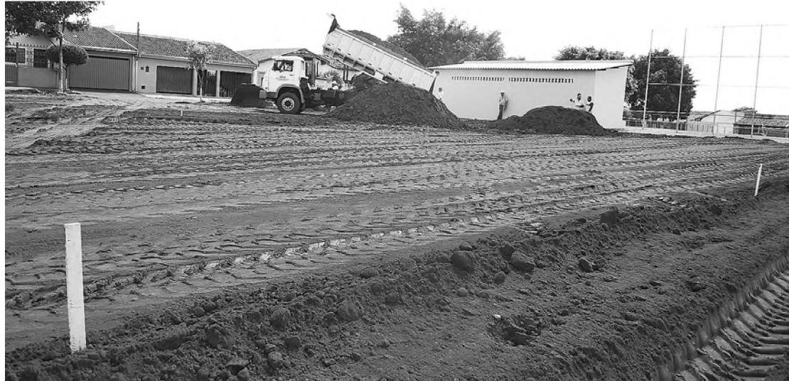
Desde a quarta-feira 24 máquinas trabalham na terraplanagem em terreno do Jardim América
