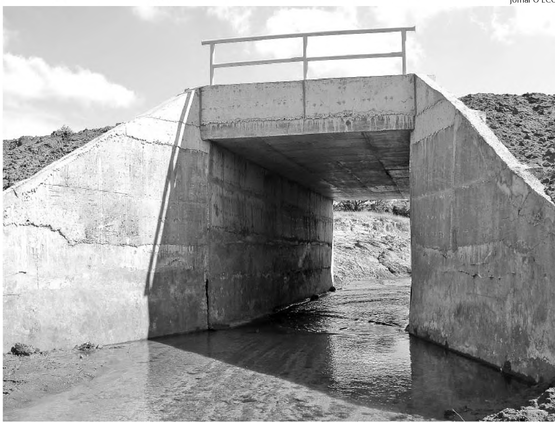
Após obras da prefeitura, ponte sobre o Ribeirão das Antas já está liberado para o tráfego
