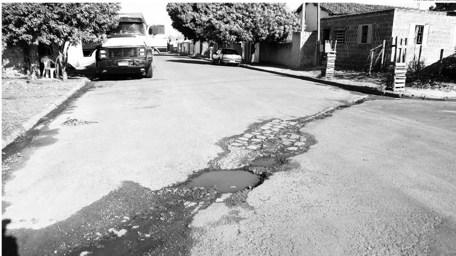
Na rua Dos Macucos, cruzamento com Das Araras, a falta de sarjetão provoca buracos e poças de água; população reclama
