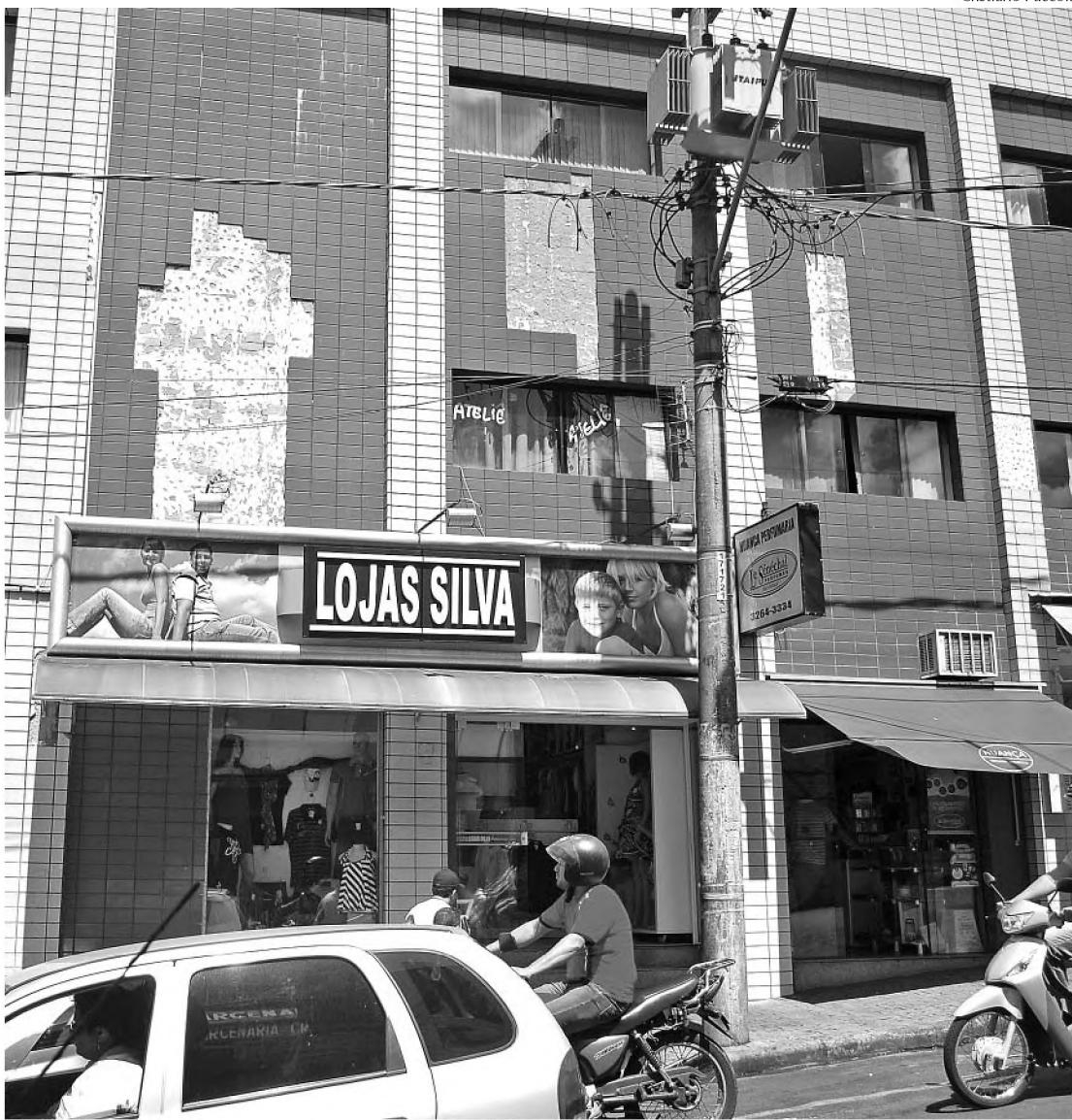
Revestimento solta, cai na calçada e assusta lojistas e pedestres; Prefeitura pede reforma
