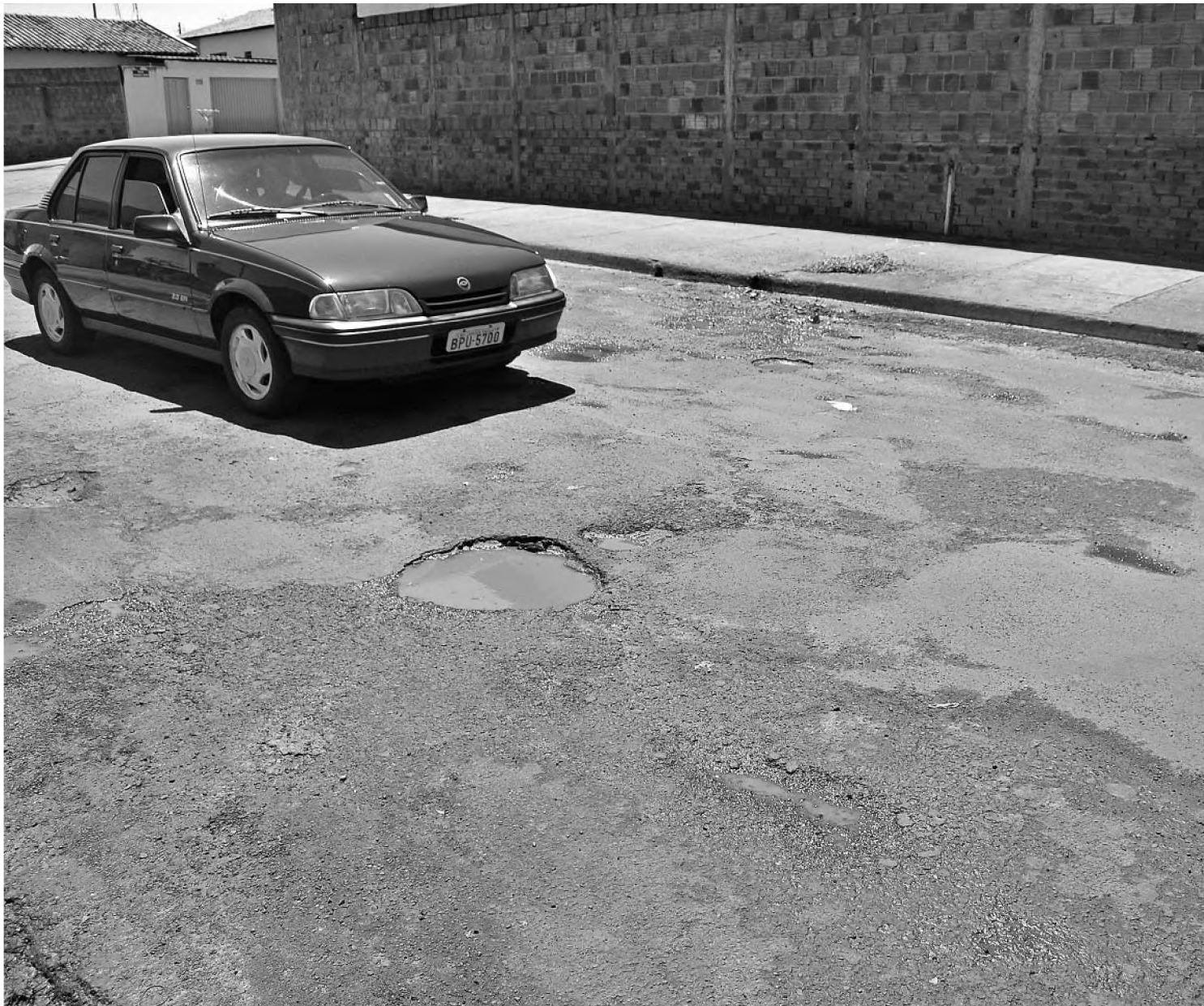
A rua Bandeira Tribuzi interliga três bairros e está cheia de buracos; Prefeitura anuncia galerias pluviais para conter o problema
