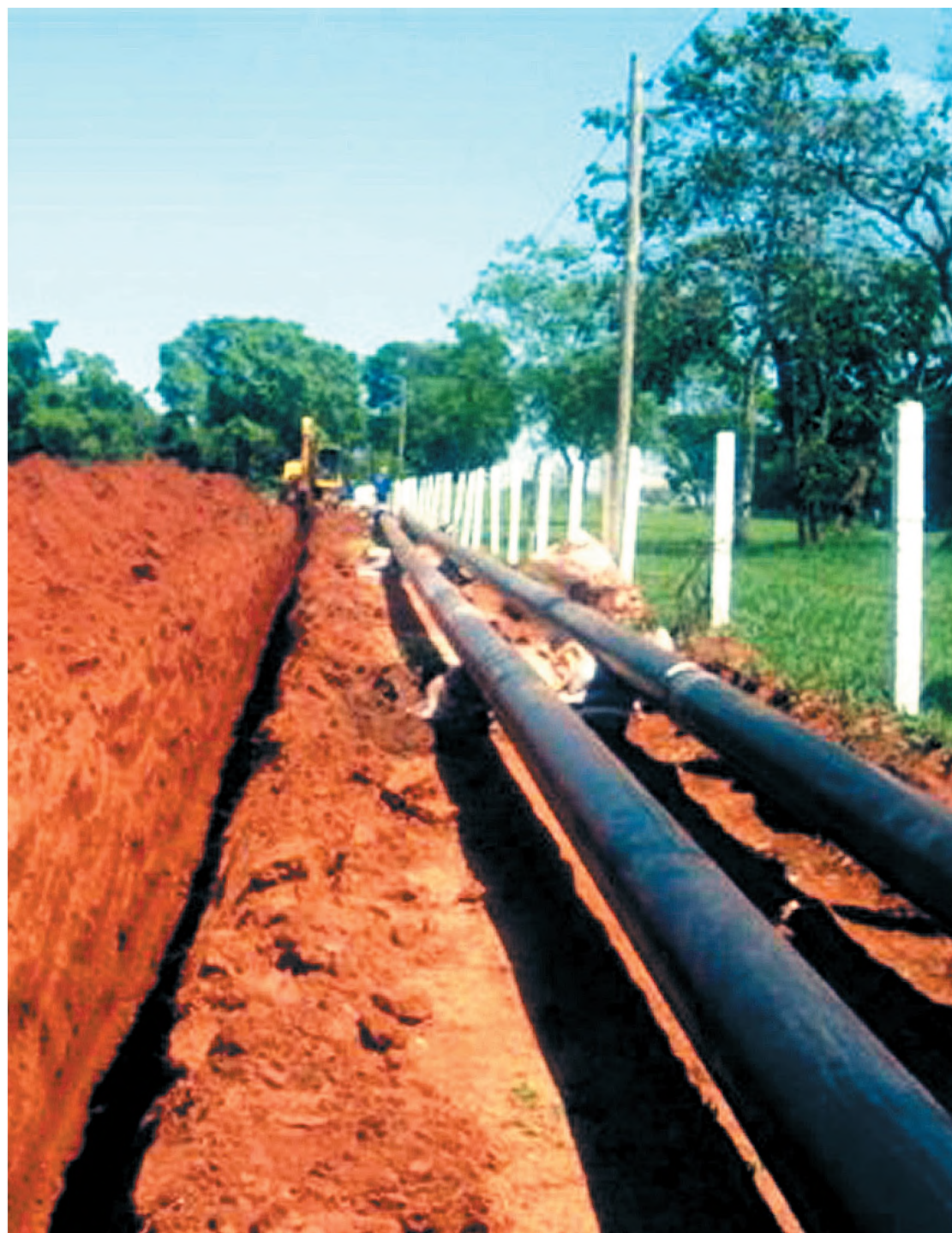
Obras do gasoduto na rodovia Comandante João Ribeiro de Barros, entre Bauru e Pederneiras
