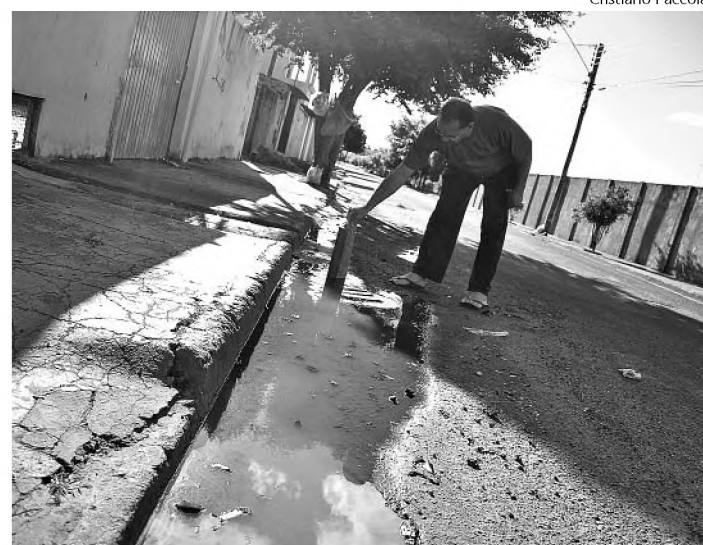
Macedo mostra água parada; mau cheiro é um dos problemas
