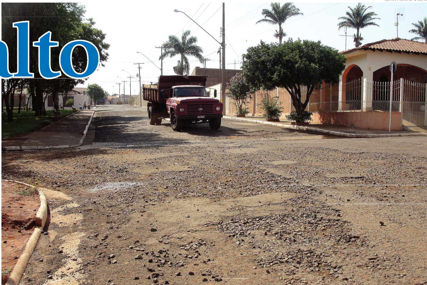
Rua Jacob Daré está cheia de buracos; moradores reclamam e Coolidge diz que vai refazer asfalto
