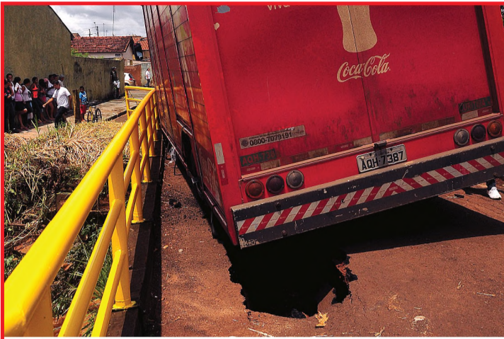
Peso do caminhão danificou ponte frágil na Vila Repke
