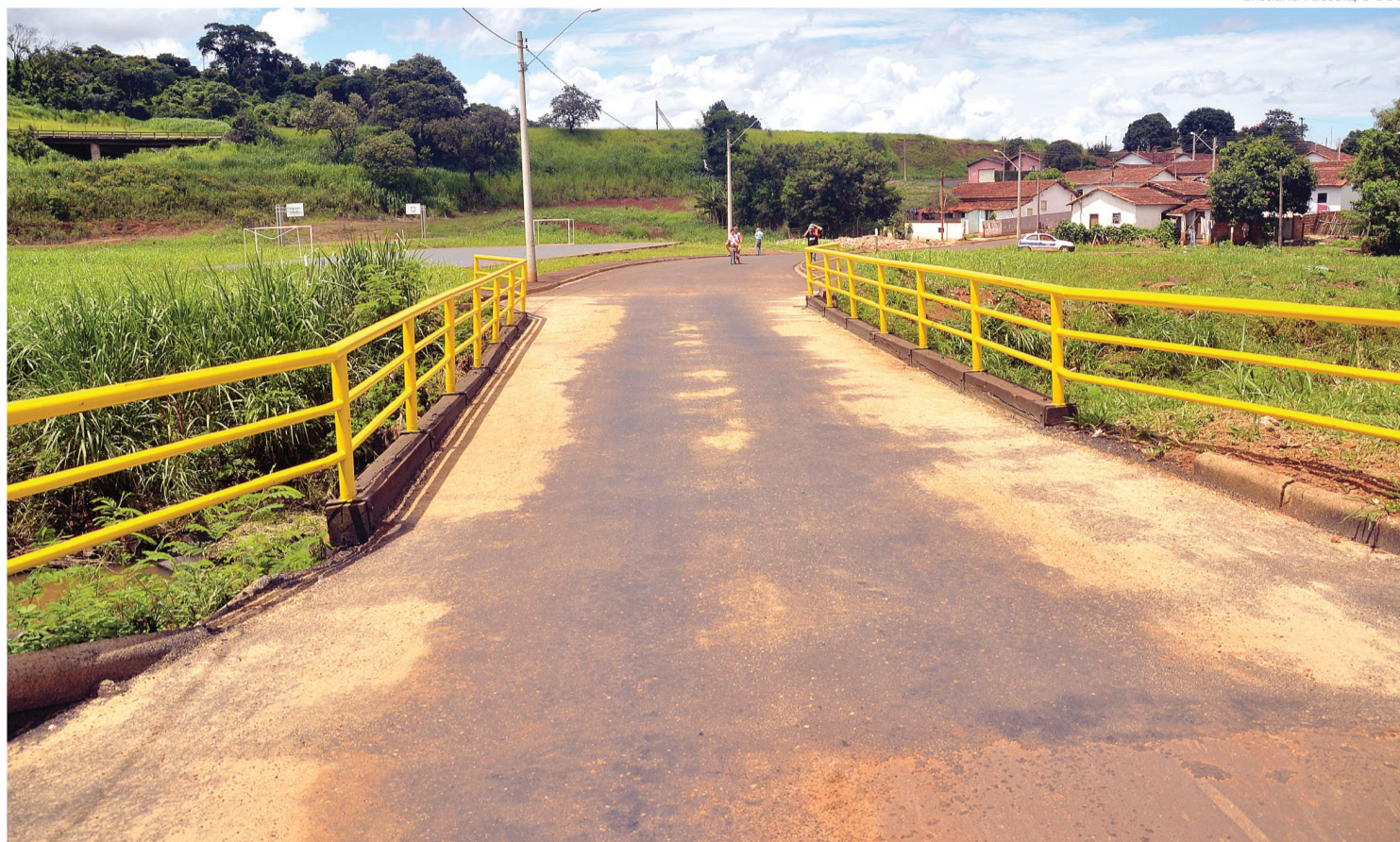
Ponte da Vila Repke que passa sobre o Rio Lençóis; técnicos estaduais acham que deve ser retirada e leito do rio alargado
