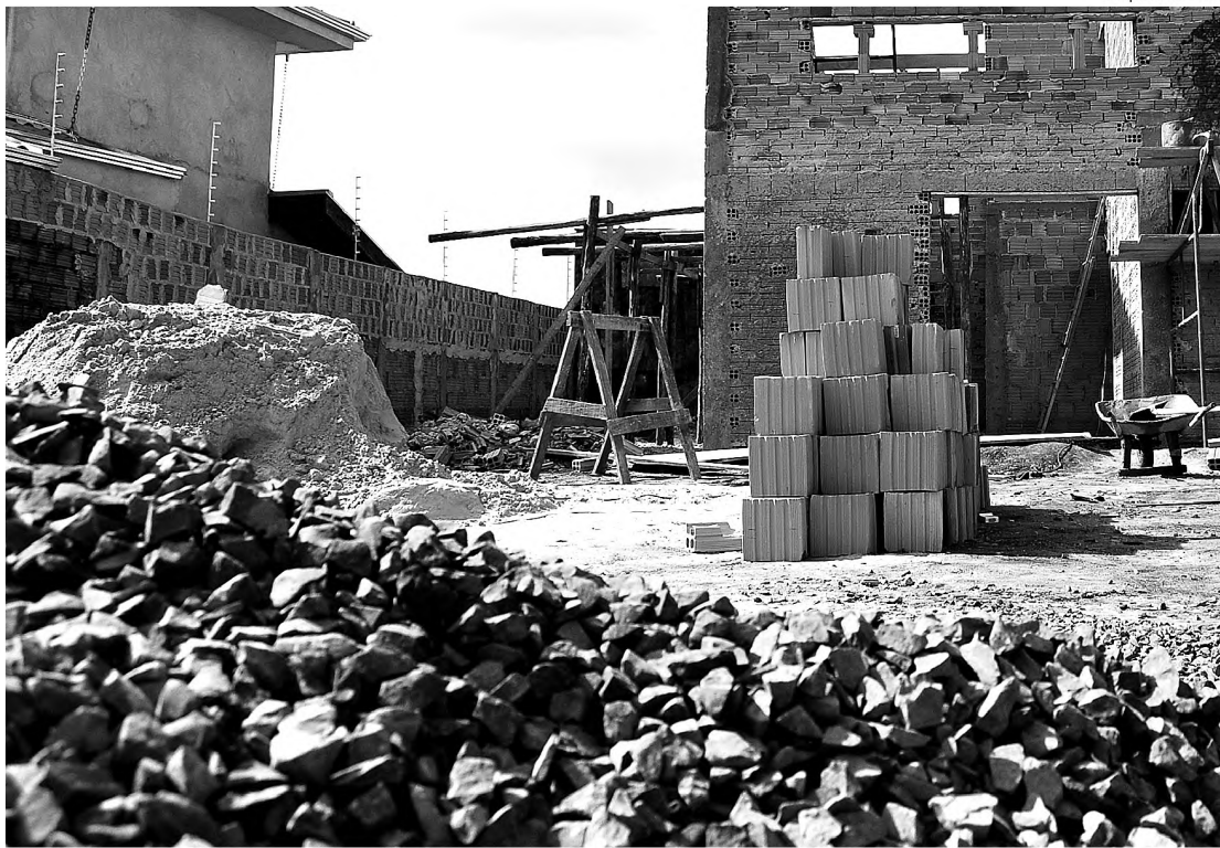
Donos de construções devem ficar atentos, pois os ladrões intensificaram ações sobre obras
